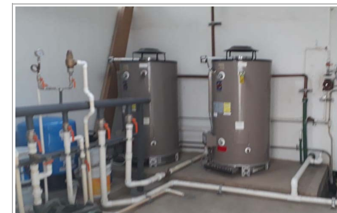
F5: Cuarto de máquinas
