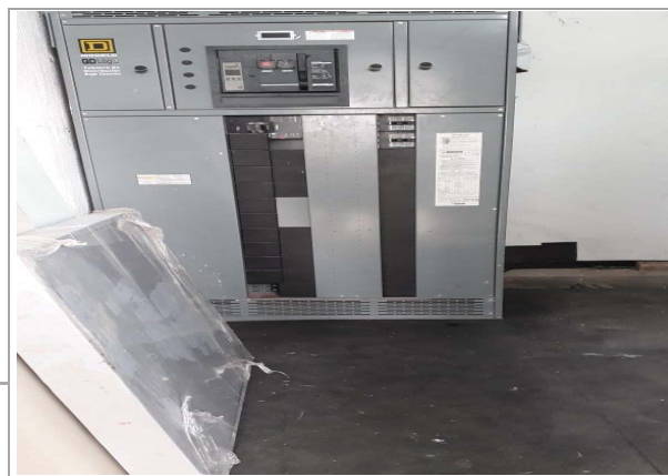
F3: Cuarto Eléctrico
