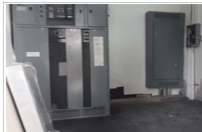
F4: Cuarto Eléctrico
