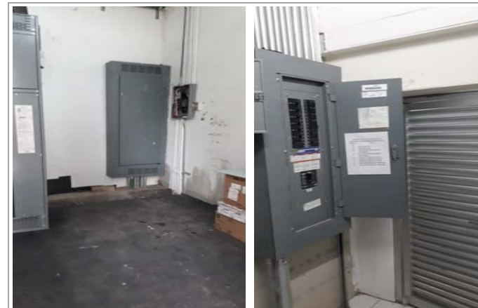
F2: tableros Cuarto de máquinas
